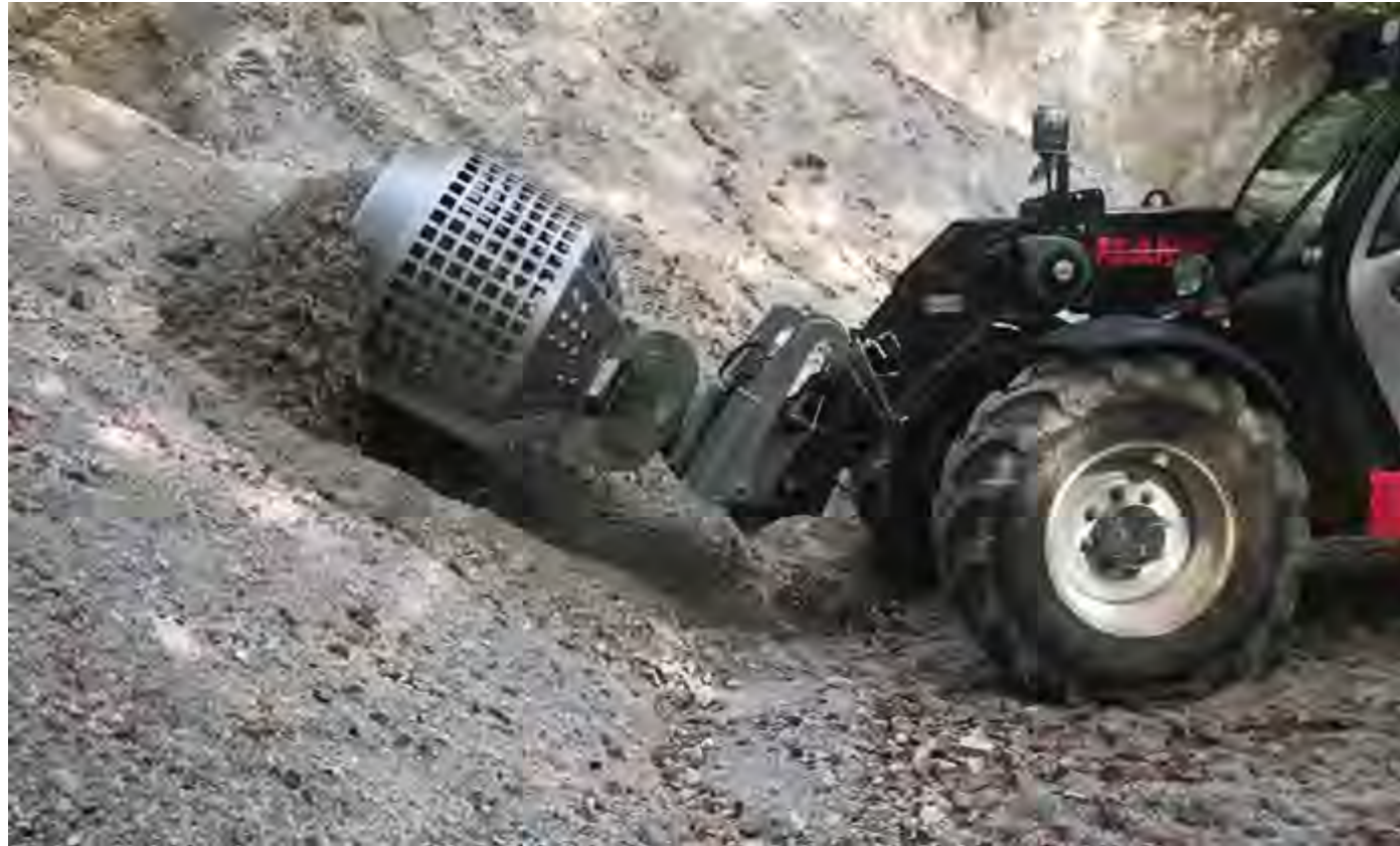
Befüllen der Siebtrommel mit Schotter für eine effiziente Sortierung - Fein- und Grobfraction
